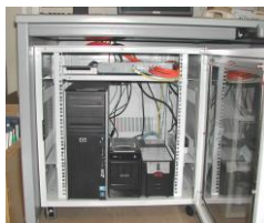
↑ サーバー内部 ここで CD に画像コピーします。
