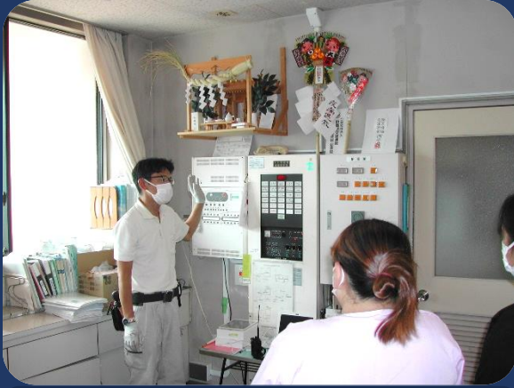
火災報知器の説明を受けている様子
